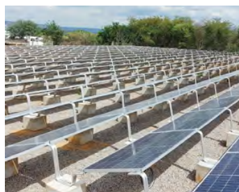
● Estrutura de solo com placas de captação da luz solar, instaladas no Distrito de Morais, em Araripina
